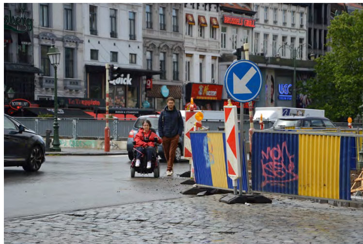
Fig.131 : Problème au niveau de la traversée.
