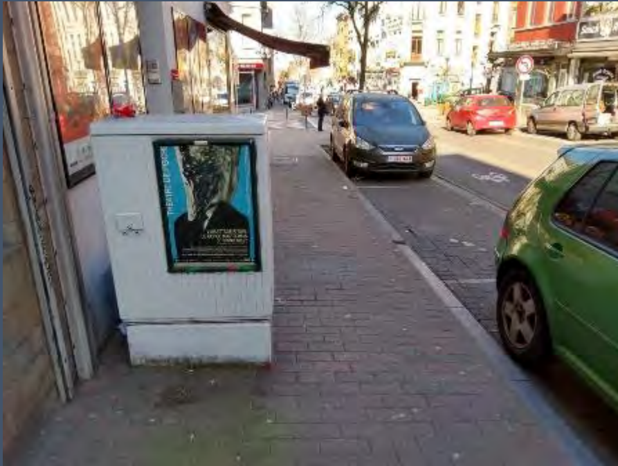
Fig.30 : Positionnement non conforme d'une armoire de concessionnaire sur la Chaussée d'Alseberg, n° 15.
