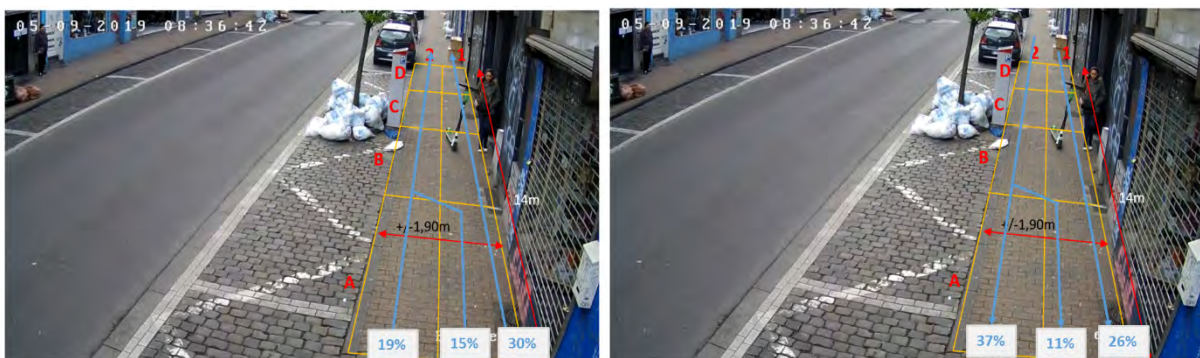
Fig.104 : Caméra « Bullet 4 » installée à la Chaussée de Waterloo
