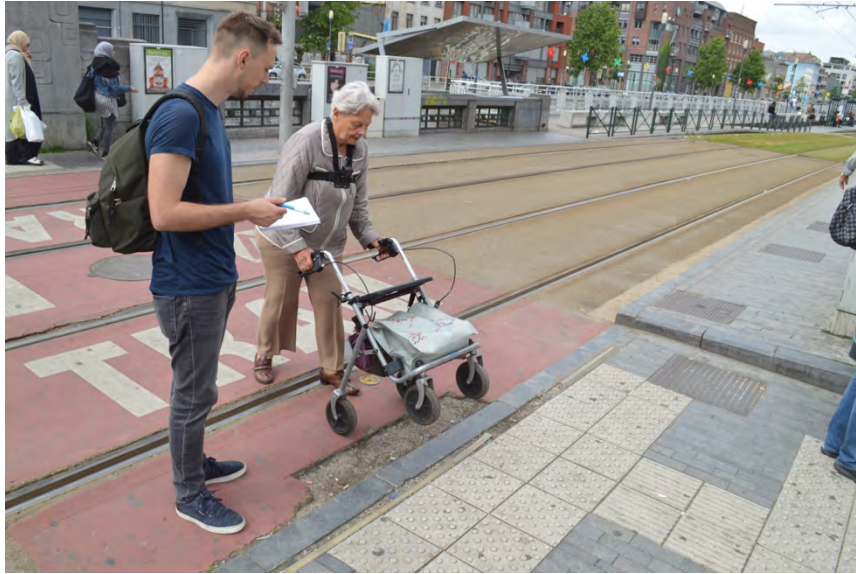
Fig.119 : Problème de revêtement sur la traversée de la voie de tram.
